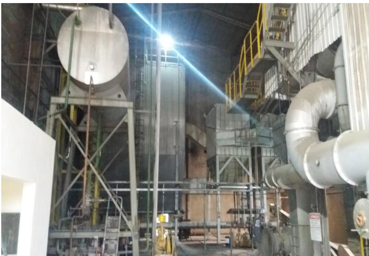
Figura 3. Caldeira, filtro de mangas, tanque de alimentação de água descrito por Autor (2017).
