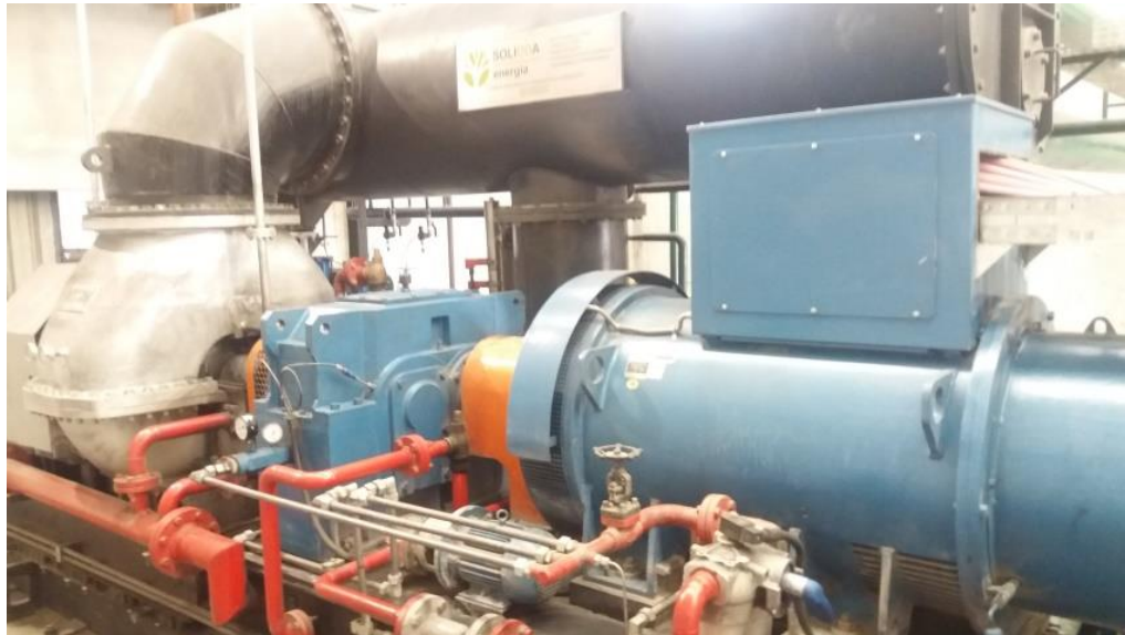
Figura 4. Turbogenerador, descrito por Autor (2017).
