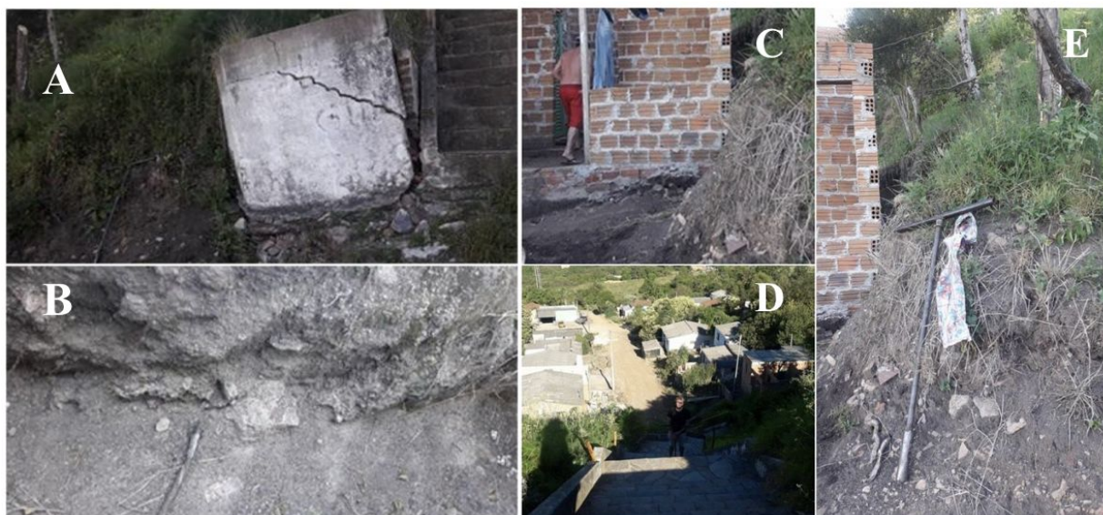
Figura 2 - Foto mosaico com as análises e coletas realizadas no local sendo A) Muro cedendo devido a desmoronamento; B) Base do Talude; C) Escorregamento gravitacional cedendo a casa do morador; D) Declividade do talude; E) Base da encosta exposta.
